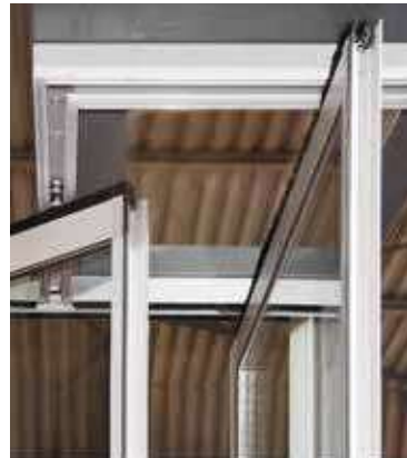
パネルを収納するパーキング部分
